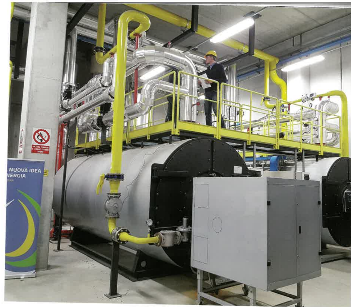
Fig.2: Centrale di Teleriscaldamento di Alessandria
